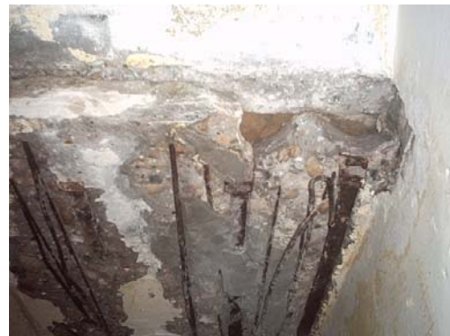
(d) Round mild steel bars in concrete. (Abu Asi Building- Gaza)
